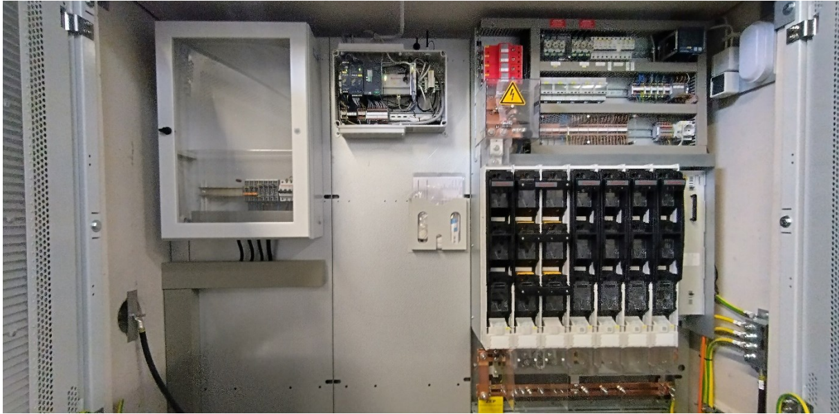
Bild 17: Niederspannungs-Nische einer Transformatorstation für den Einsatz in Quartieren (Ortnetzbereich). In der Nische befindet sich ein Edge-System zur Datenübertragung (kleines Automationsgehäuse in der Mitte), welches z.B. das Energiemanagement und die Umsetzung steuerbarer Verbrauchseinrichtungen (wie Wärmepumpen, Wallboxen) nach §14 EnWG unterstützen kann. Bild: Fritz Husemann GmbH & Co. KG.
